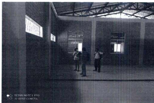
Fotografía 3. Instalaciones internas para la planta de procesamiento.
